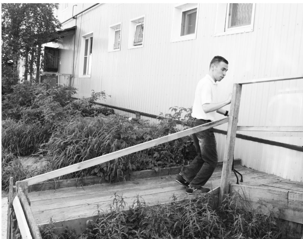
ПАНДУС, ПОСТРОЕННЫЙ УК, У ДОМА №2 ПО М.БАЕВА, НЕ СООТВЕТСТВУЕТ ТРЕБОВАНИЯМ ДОСТУПНОСТИ
